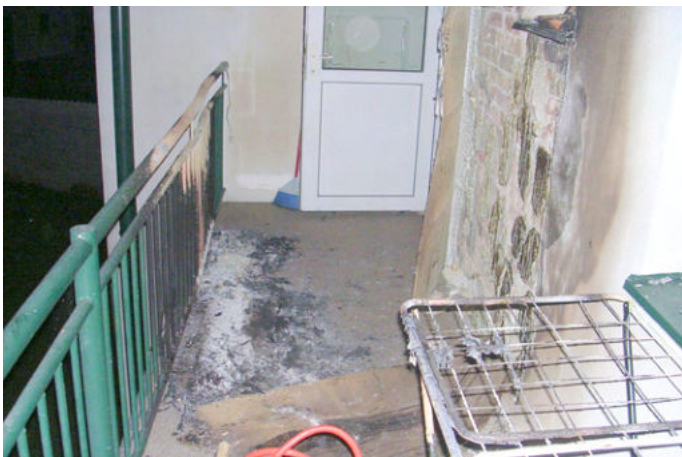
Fassade und Fenster wurden schwer beschädigt.
